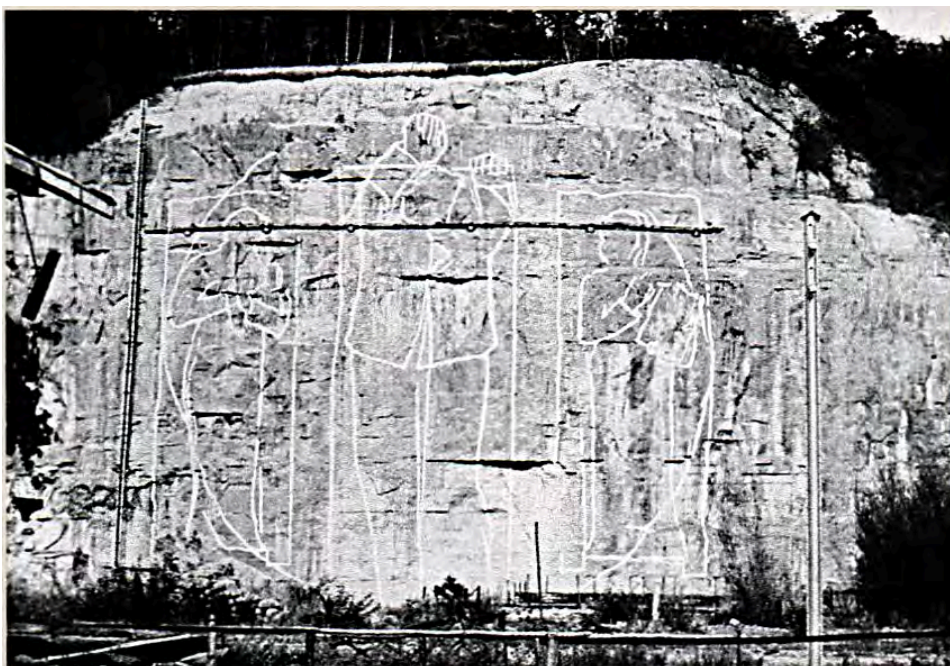
Fig. 31 -La paroi des Andonces au 5 septembre 1947. Le monte-charge de 36 mètres, la passerelle de 42 mètres et le tracé des trois sculptures projetées.
